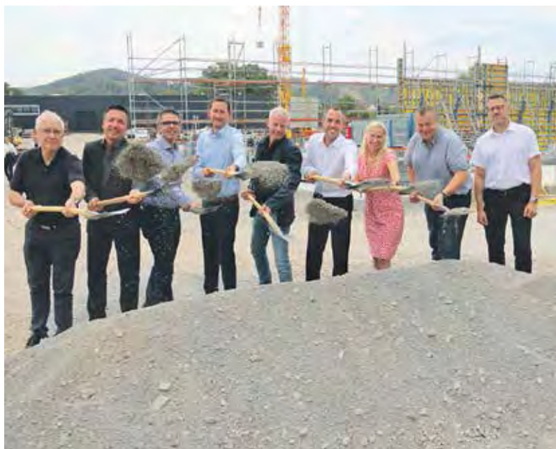
Der Startschuss ist erfolgt. Mit einem symbolischen Spatenstich wurden Ende August die Bauarbeiten für ein neues Ärztezentrum am Berliner Ring offiziell begonnen. Die Arbeiten für den ersten Bauabschnitt werden voraussichtlich im Sommer 2109 enden.
